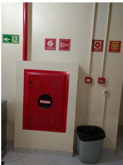
Figura: Hidrante; Alarme de incêndio e Bomba de Incêndio
